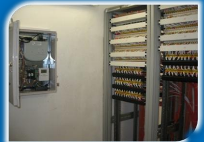
Server / Lan Rooms
